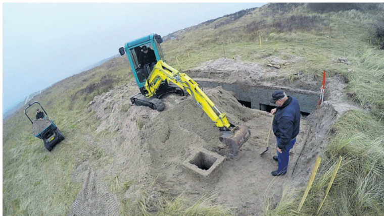
Er is een begin gemaakt met het uitgraven van bunkers. FOTO DIRK BRUIN
